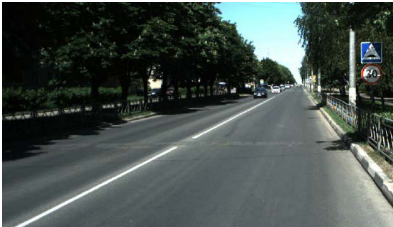
Рисунок 1.6.2.3 – Отсутствие необходимой дорожной разметки 1.25 (п. 6.3.2 ГОСТ 50597-2017), ул. Курчатова, 1.
