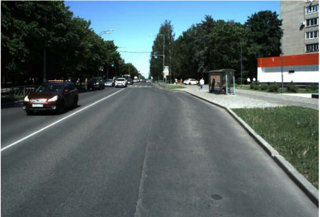
Рисунок 1.6.2.1 – Отсутствие горизонтальной дорожной разметки 1.17.1 (п. 6.3.2 ГОСТ 50597-2017), ул. Курчатова, 13
