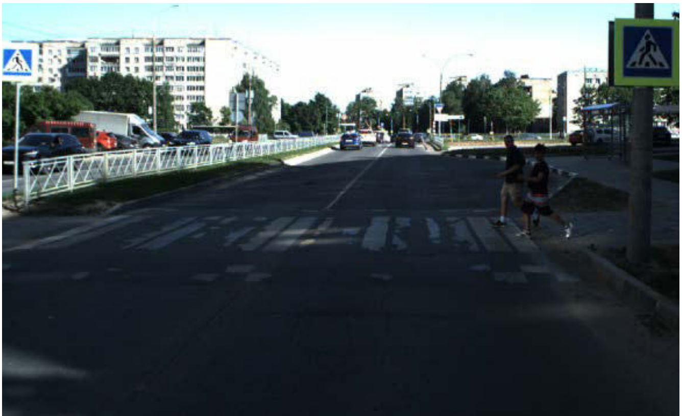
Рисунок 1.6.2.2 – Изменение светотехнических характеристик и износ дорожной разметки 1.14.1 (п. 6.3.2 ГОСТ 50597-2017), ул. Белкинская, 3
